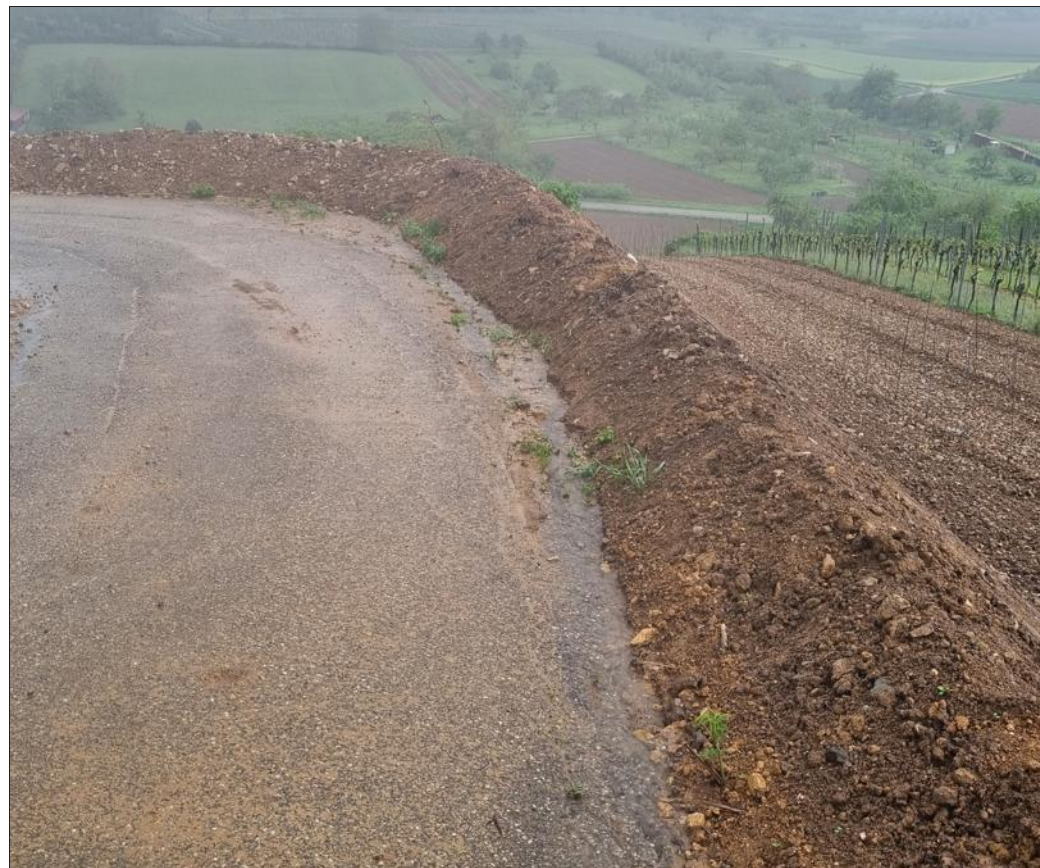
Pascal Meyer a réalisé un talus pour empêcher l'eau de s'écouler. Mais pour lui, cette solution n'est pas suffisante en cas de gros orage. Document remis
